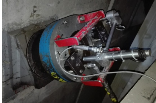
Figure 9. Matériel de pesage mis en place
