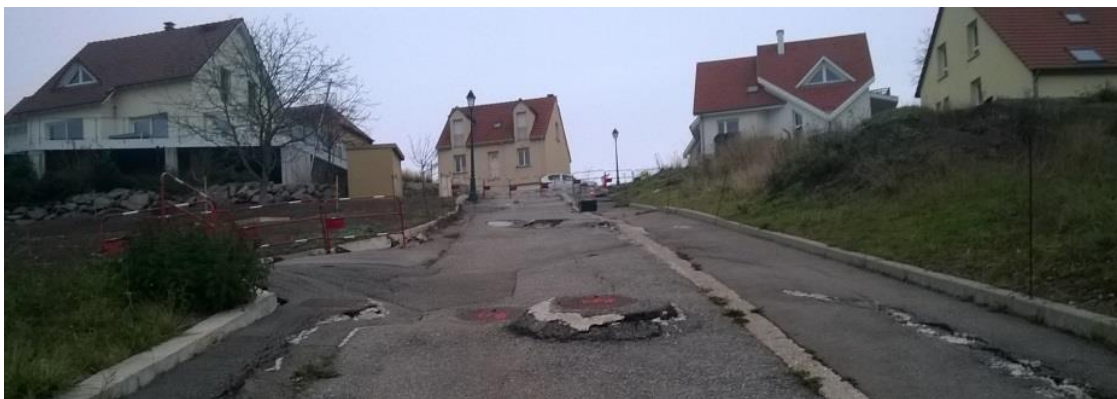
Figure 2 – Dégradations constatées sur les infrastructures (2015)
