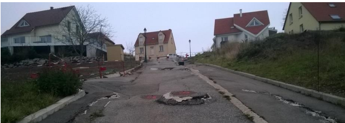
Figure 2 – Dégradations constatées sur les infrastructures (2015)
