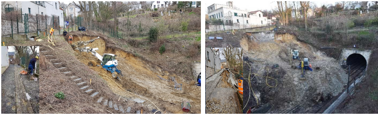
Figure 3. a) régression du 21 février b) 3 mars effondrement de la route
