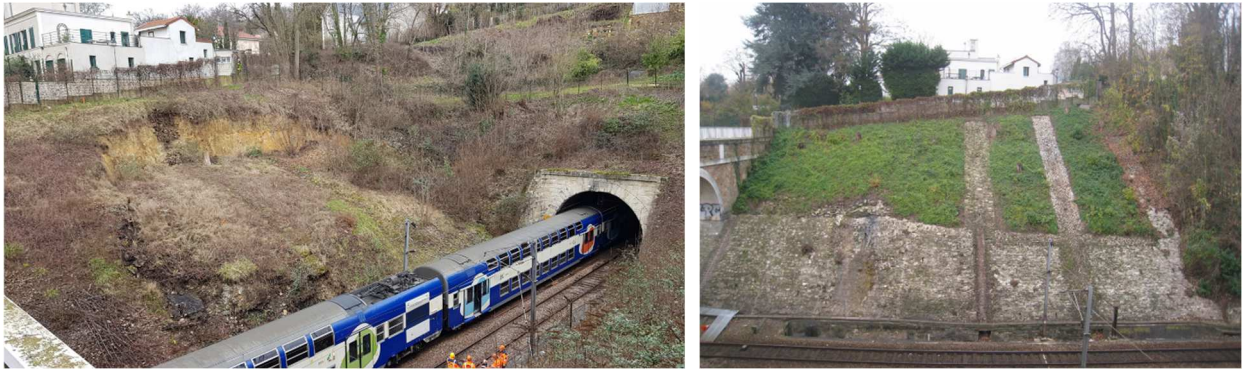
Figure 1. a) Glissement de talus du 4 février 2020 - b) photo avant glissement
