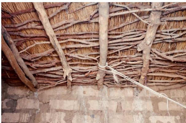
Toiture terrasse en terre dans le village de Baasneere (Région Centre-Nord) – © María Lidón de Miguel
