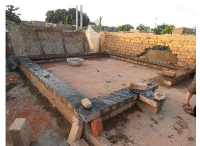
Cette maison (dont les murs seront en adobe) a une fondation en blocs de ciment pleins, plus une plateforme surélevée par rapport au terrain environnant, plus un soubassement en blocs de ciment pleins et une barrière capillaire en film polyane pour éviter les remontées capillaires dans les murs en adobe (maison à Fada N'Gourma, Région Est) – © Enrique Sevillano Gutiérrez, CRAterre
