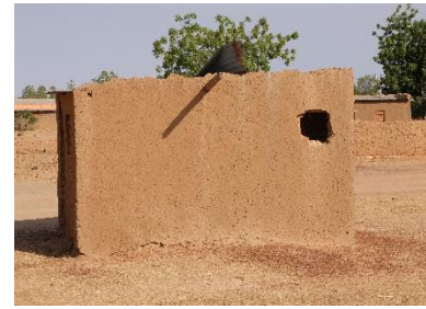
Les forts vents arrachent les toitures en tôle qui ne sont pas mise en œuvre dans les règles de l'art, dont leur débord fait face aux vents dominants, qui ne sont pas bien ancrées à la structure, etc. (Région Centre-Ouest) – © Olivier Moles - CRAterre
