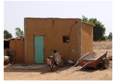
Le manque de fondations, de chaînage et de traitement des abords, les variations de teneur en eau du terrain, en plus du possible fait que le sol ne soit pas stable sont à l'origine de nombreux problèmes structurels dans les murs des maisons (Région Centre-Ouest) – © Olivier Moles - CRAterre
