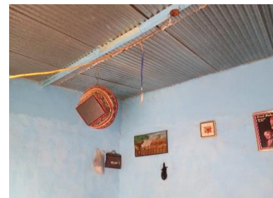
Les familles font des économies dans le nombre de chevrons utilisés pour les toitures en tôle (minimum un chevron à chaque extrémité et un au milieu) au détriment de la stabilité de ces toitures et la durabilité de l'ensemble du bâtiment (Ouagadougou) – © Enrique Sevillano Gutiérrez - CRAterre
