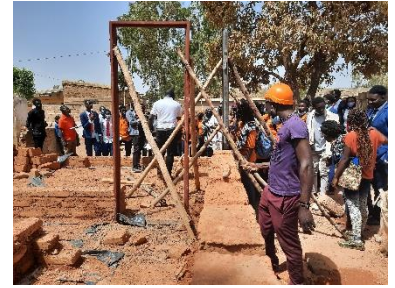
Chantier démonstratif de maison en adobe ouvert au grand public effectué par l'association Yaam Solidarité dans le quartier de Boassa, Ouagadougou, à l'occasion du Festival Fact Sahel + 2022 . Aujourd'hui, il est nécessaire de trouver de nouvelles façons de transmettre les savoirs et savoir-faire constructifs – © Enrique Sevillano Gutiérrez, CRAterre
