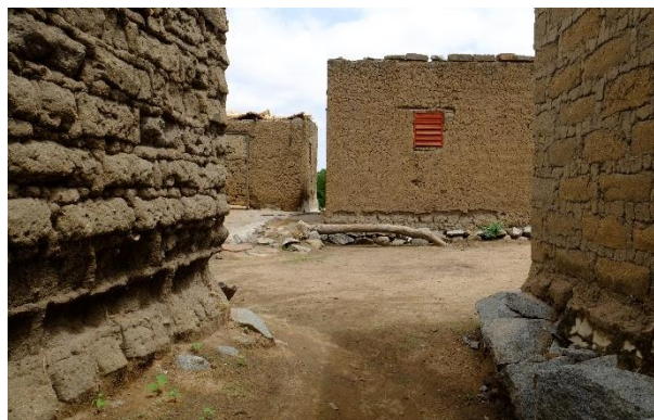
Fondations en pierre à Kouro (Région du Boucle du Mouhoun) – © Nuria Sánchez Muñoz, CRAterre
