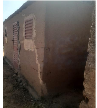
Les ouvertures sont souvent des points de faiblesse dans les constructions : distance insuffisante avec les angles ou entre ouvertures, absence de linteaux, mauvais ancrage aux murs... (Ouagadougou) – © Yaam Solidarité
