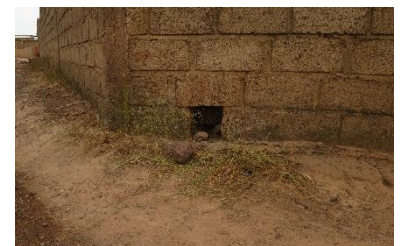
Les trous dans les bases des murs de clôture pour l'évacuation des eaux de pluie sont très courants (Boassa, Ouagadougou) – © Enrique Sevillano Gutiérrez, CRAterre
