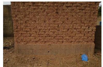
Construction avec soubassement en blocs de sable-ciment et élévations des murs en adobe (Boassa, Ouagadougou) – © Enrique Sevillano Gutiérrez - CRAterre
