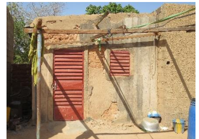
Le décollement des enduits dans les murs en terre est très courant lorsqu'on utilise des matériaux non compatibles tels que des enduits en ciment très dosés (Ouagadougou) – © Enrique Sevillano Gutiérrez - CRAterre
