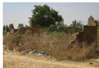
Des constructions de tous les types subissent les effets de l'instabilité structurelle à cause d'une mauvaise exécution et d'un entretien insuffisant (Ouagadougou) – © Enrique Sevillano Gutiérrez - CRAterre
