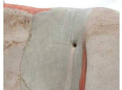
Comme le montrent ces deux images, l'entretien des descentes d'eau dans les toitures terrasses est essentiel pour la durabilité des constructions (Région Centre-Sud) – © Wilfredo Carazas Aedo - CRAterre
