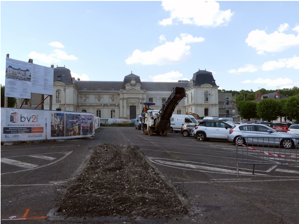
Figure 6 : Rabotage d'une des tranchées place de Verdun. À gauche : l'aire de chantier du Palais de Justice ; à droite : le maintien des stationnements
