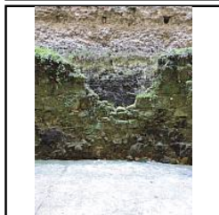
Photo 90 Parement sud du mur M2 avant dévégétalisation - (Papin Pierre)
