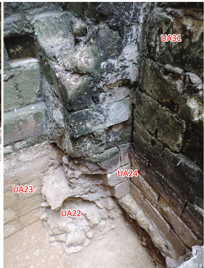
Figure 79 : photographie de détail de l'insertion de la partie basse de la maçonnerie du mur de refend dans le pilastre (sondage 2)
