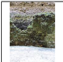
Photo 89 Parement sud du mur M2 avant dévégétalisation - (Papin Pierre)
