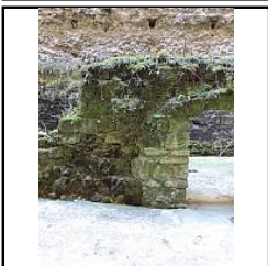
Photo 88 Parement sud du mur M2 avant dévégétalisation - (Papin Pierre)
