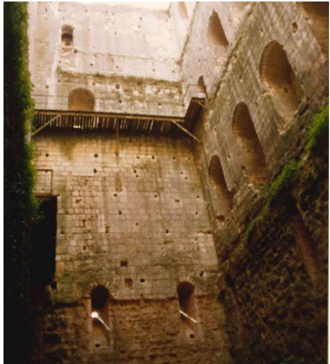
Figure 45 : photographie de la face intérieure est, de 1988 avant la restauration de la tour (A. de Saint-Jouan)
