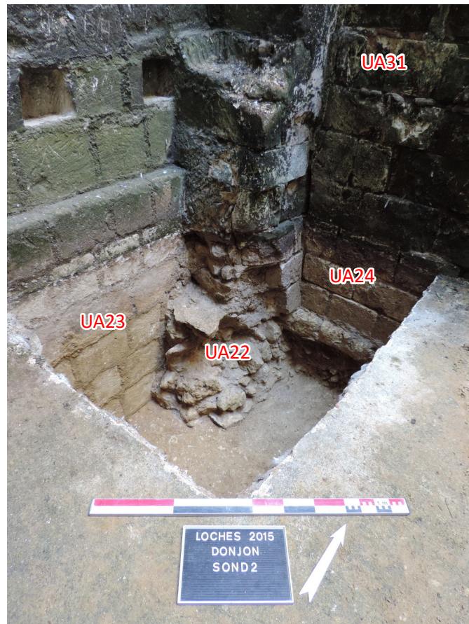
Figure 70 : photographie de la fondation du pilastre soutenant l'arcature contre le mur ouest de la tour maîtresse
