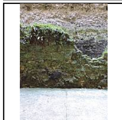
Photo 91 Parement sud du mur M2 avant dévégétalisation - (Papin Pierre)
