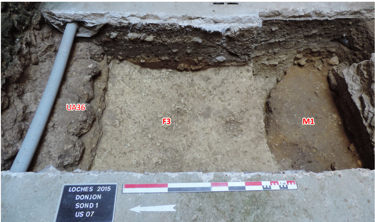
Figure 67 : apparition de la tranchée de fondation F3, percée dans le talus du rempart M1, et comblé déchets de construction venant contre le ressaut maçonné du mur nord de la tour maîtresse
