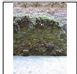
Photo 92 Parement sud du mur M2 avant dévégétalisation - (Papin Pierre)
