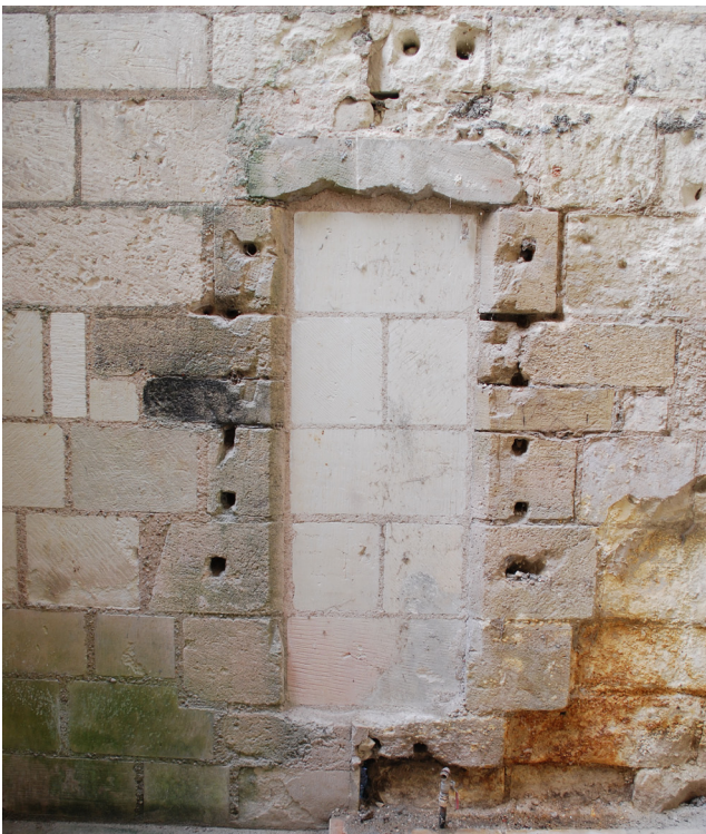
Figure 69 : Vue de la fenêtre F10, transformée en porte P29, au niveau 1 de l'aile sud, mur est (M4, parement extérieur)
