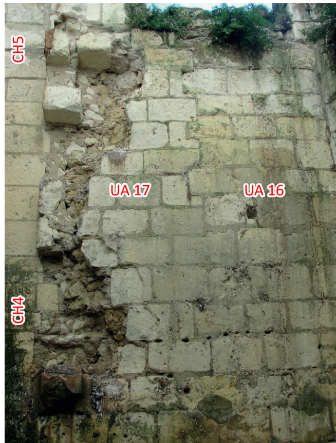
Figure 42 : Détail du parement conservé de l'enceinte « Henri II » à l'intérieur de la « Tour-Neuve » (M5, UA16), avec le coup de sabre pour l'insertion des cheminées (cliché K. Pellerin).
