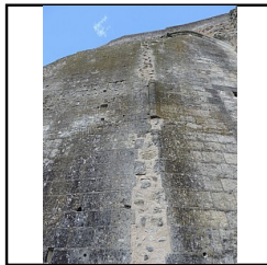
Photo 16 arrachement de M1 avec vestiges de la porte P17 - (Pellerin Kevin)
