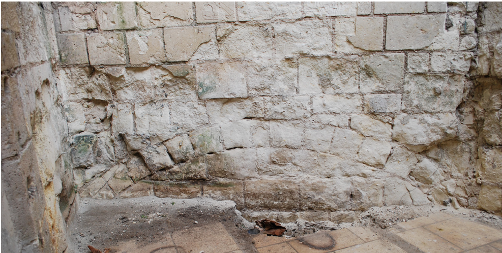
Figure 47 : Arc de décharge UA94, à la base du mur M6 de la cage de l'escalier à vis
