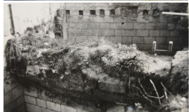
Figure 80 : Documents issus du dossier de restauration de 1945, par B. Vitry (Calepinnage et photographie, MAP 0081/037/0052)
