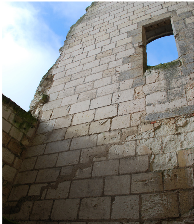
Figure 70 : Vue de la fenêtre F8, transformée en porte P9, associée à la trace d'escalier (UA89), au niveau 2 de l'aile sud, mur est (M4, parement extérieur)
