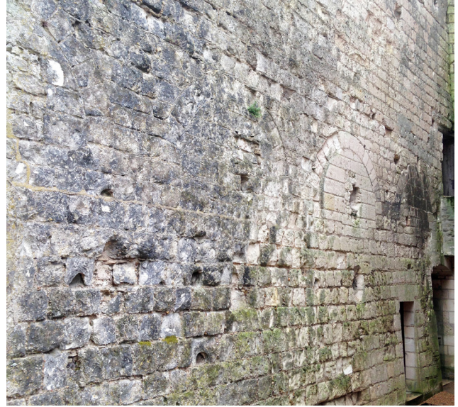
Figure 39 : Vue de la chemise sur le front nord, avec la série d'arcades (bouchées) dans la surélévation
