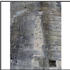
Photo 15 détail de l'arrachement de M1 - (Pellerin Kevin)
