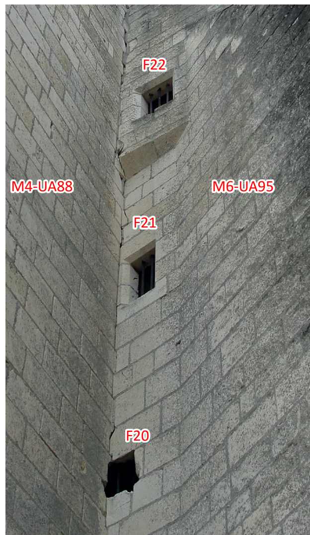
Figure 48 : Vue de détail de l'ancrage du mur M4 dans le mur M6 de la «Tour Neuve»
