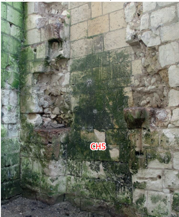
Figure 57 : Vue de détail de la cheminée du niveau 1 de l'aile sud (M5, CH5) (cliché K. Pellerin).
