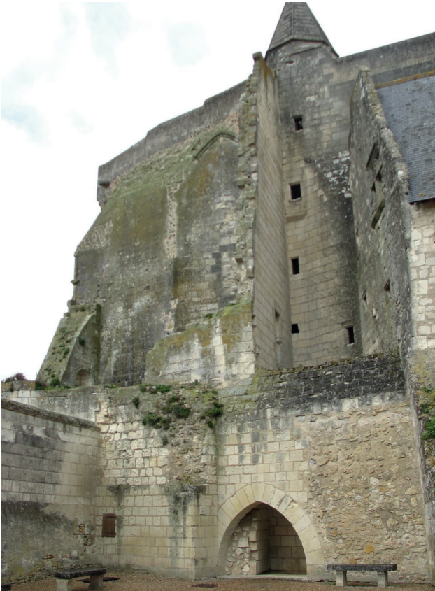
Figure 7 : Vue d'ensemble du secteur prescrit : l'aile sud effondrée de la «Tour Neuve» et l'espace adjacent, immédiatement à droite.
