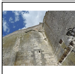
Photo 25 Arrachements des voûtes, niveau 3 - (Pellerin Kevin)
