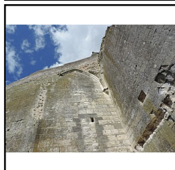
Photo 25 Arrachements des voûtes, niveau 3 - (Pellerin Kevin)
