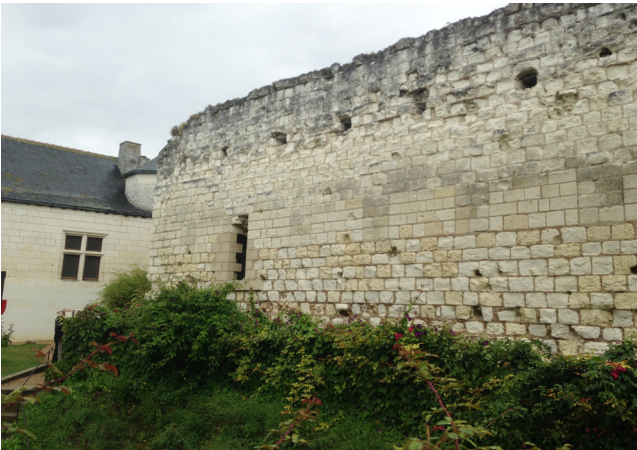
Figure 38 : Vue de la chemise sur le front sud, dont la surélévation a fossilisé le crénelage du premier état
