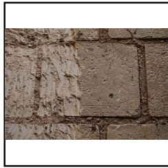
Photo 84 Détail des graffitis sur le mur M6 - (Papin Pierre)
