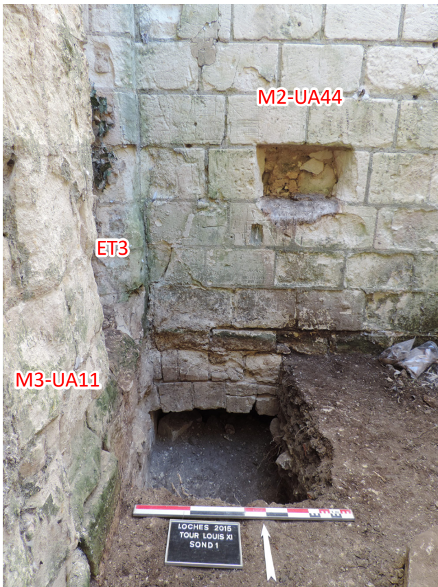
Figure 50 : Vue du sondage 1, pièce occidentale de l'aile sud de la «Tour Neuve»
