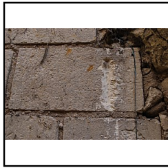
Photo 83 Détail des graffitis sur le mur M6 - (Papin Pierre)
