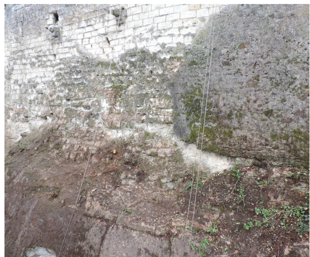
Figure 45 : Partie basse dégradée des remparts à mi-hauteur (©Sadil)
