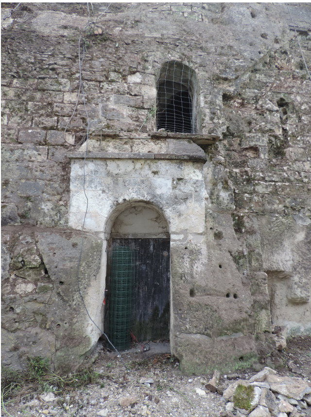
Figure 26 : Vue des portes P50 (en haut), P52 et P53 (en bas) (©Sadil)
