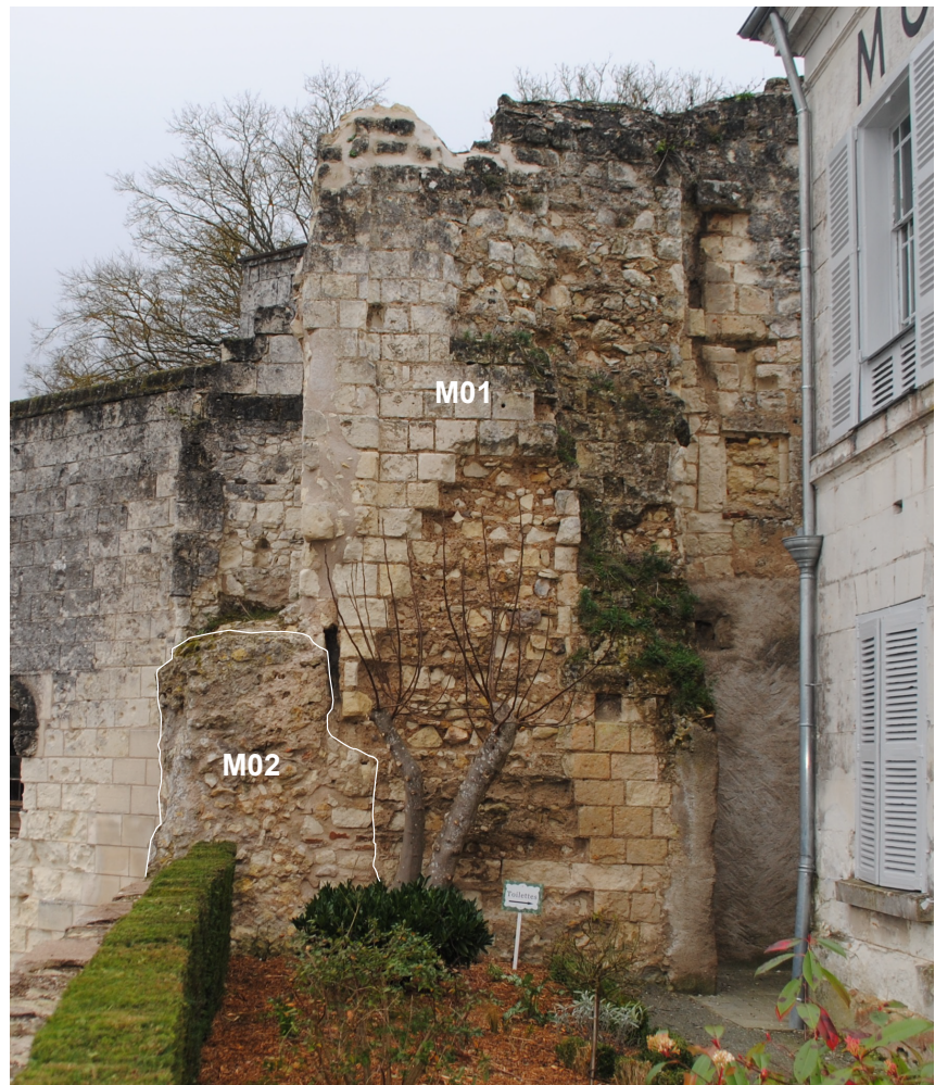
Figure 39 : Vue de M02 et M01 à l'angle du Logis du Fou et du bâtiment roman (©Sadil)
