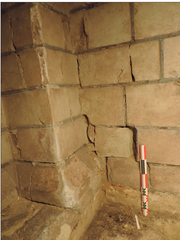
Figure 34 : Vue du collage entre le mur du déambulatoire et le piédroit de l'arc doubleau de l'accès à la crypte, sondage 4
