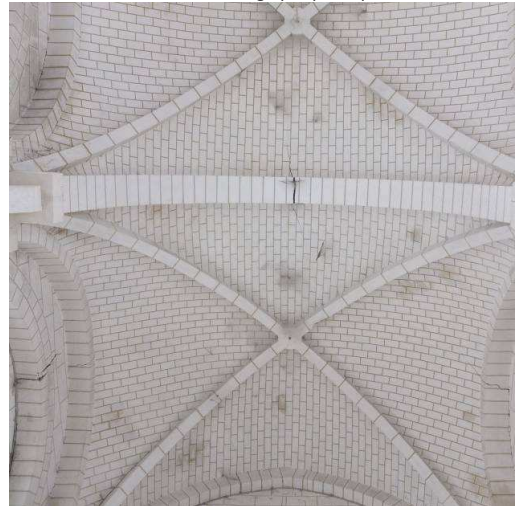
Fissuration de la voûte de la nef
