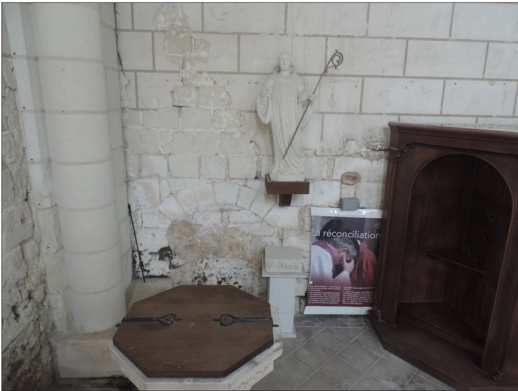
Figure 18 : Vue de l'angle nord-ouest de la nef, avec la dégradation du badigeon récent, laissant apparaître une porte à demi enterrée
