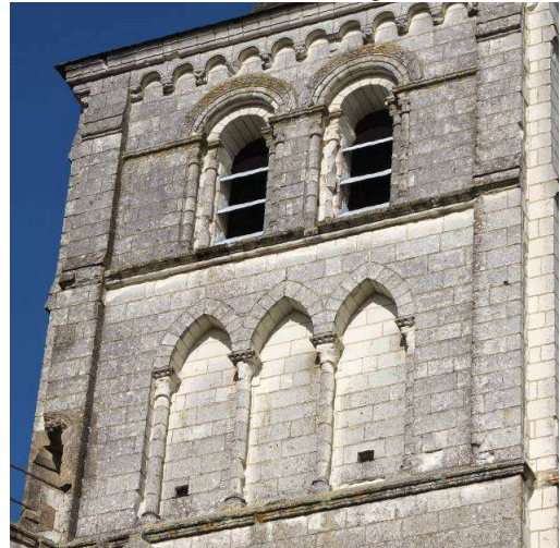
Maçonnerie du clocher dégradé en façade sud du clocher
