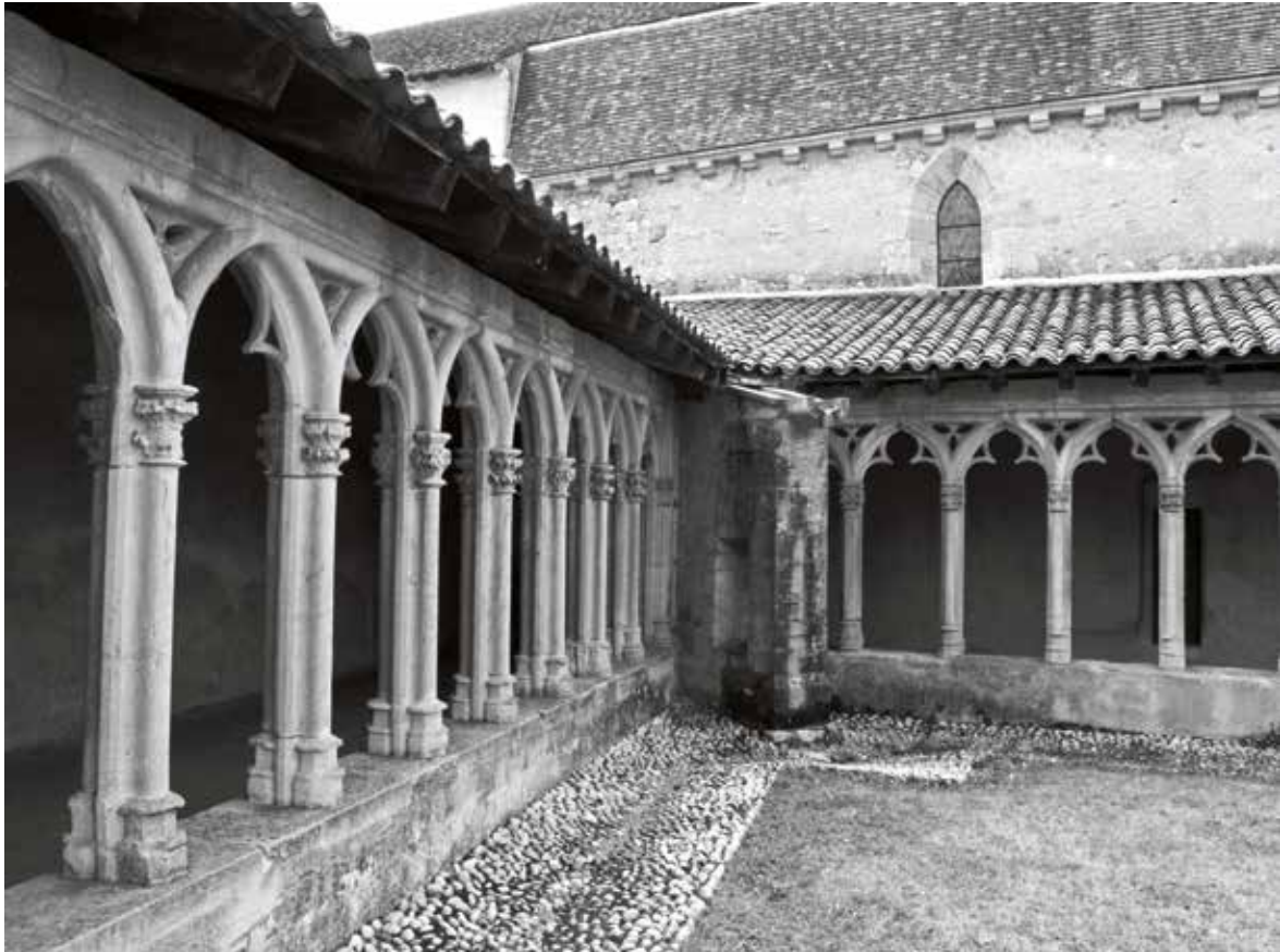
Figure 10 : Contrefort en biais situé à l'intersection des ailes nord et est du cloître de Saint-Nizier-sous-Charlieu ; Document Archeodunum SAS.
