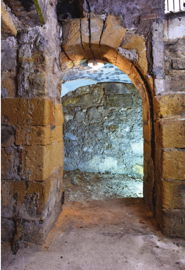
Figure 14 : Vue depuis le nord de l'entrée de la quatrième cave au sud. (M. Panneau)
