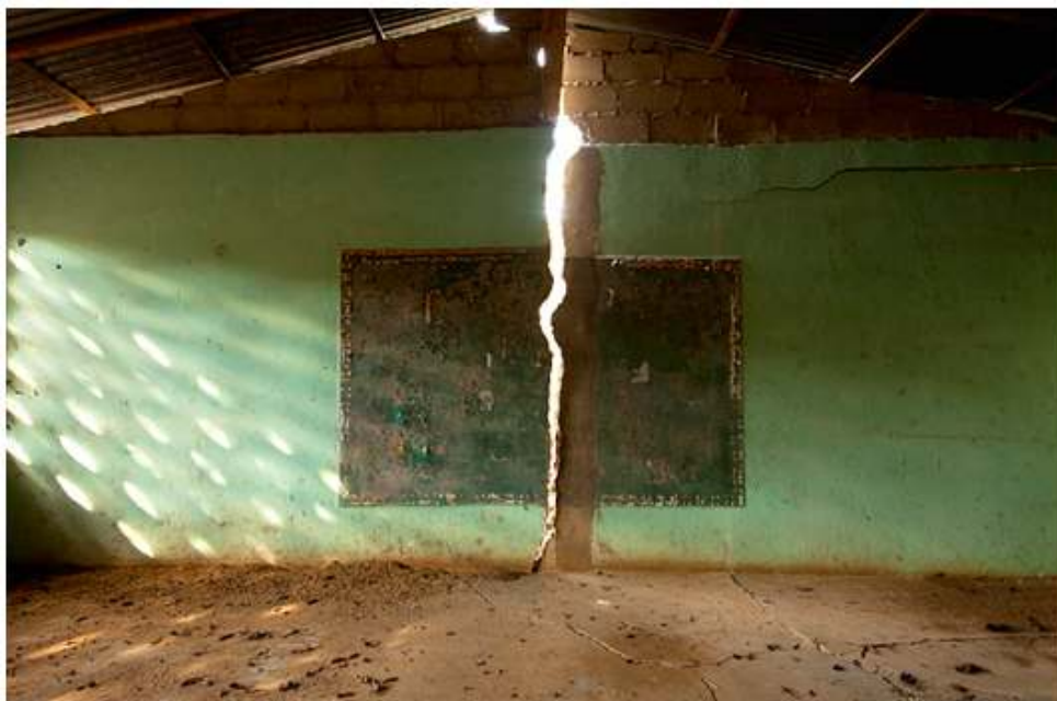
Fig. 4. Silencio con Grieta (2011)
