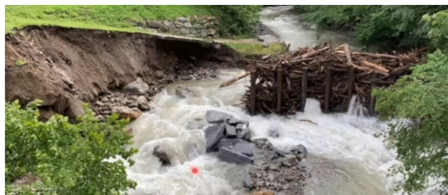
FIGURE 4.18: Exemple de râtelier pare-flottant contourné par érosion latérale pendant une crue de faible magnitude ( T \approx 2 \text{ ans?} ) sur la rivière Morobia en Suisse (Source : ©R. Boes - ETHZ). Une partie des flottants piégés sont restés en amont des pieux mais le bassin de l'ouvrage est globalement vide. Quelques blocs situés au centre de la photo laissent penser qu'une protection de hauteur insuffisante était située sur le côté de l'ouvrage. L'écoulement a atteint un niveau proche du haut des pieux (en témoignent les flottants piégés à cette cote) et a attaqué la berge.
