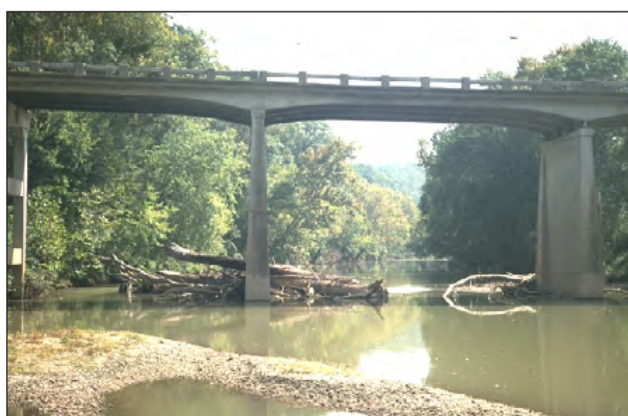
(a) Exemple d'embâcles isolés au droit de piles
