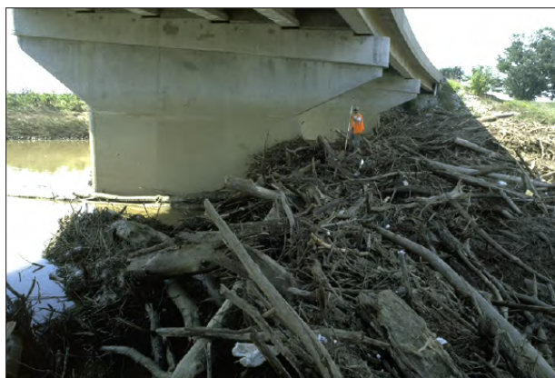
(b) Exemple d'embâcle barrant des travées
