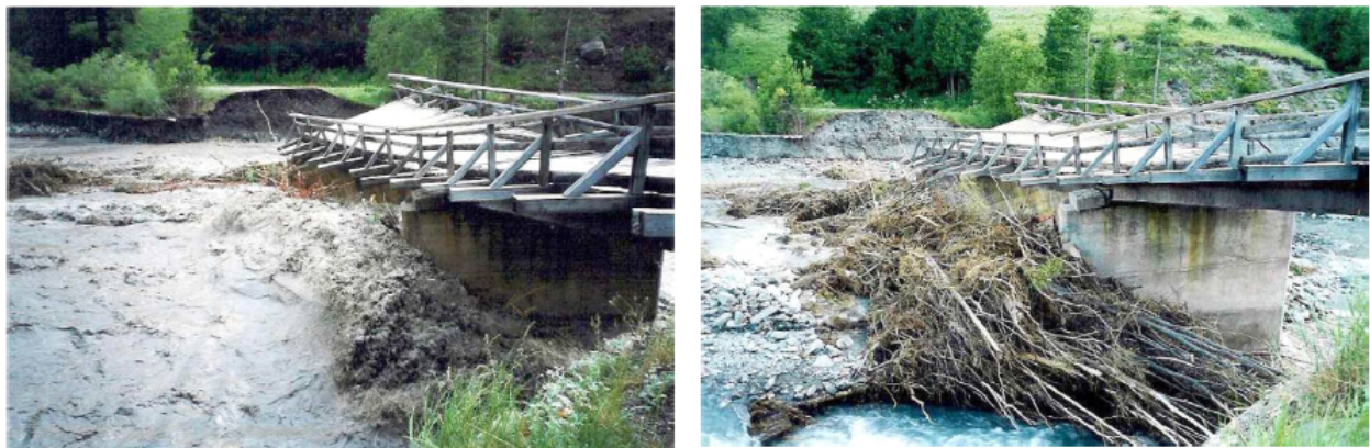
FIGURE 3.16: Affouillement d'un pont après la crue du Guil en Juin 2000 (KOULINSKI et RICHARD, 2008)
