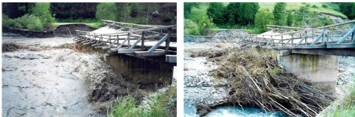
FIGURE 3.16: Affouillement d'un pont après la crue du Guil en Juin 2000 (KOULINSKI et RICHARD, 2008)
