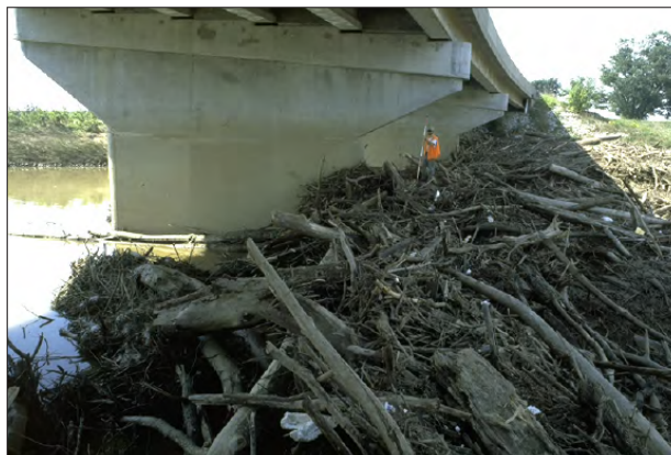
(b) Exemple d'embâcle barrant des travées
