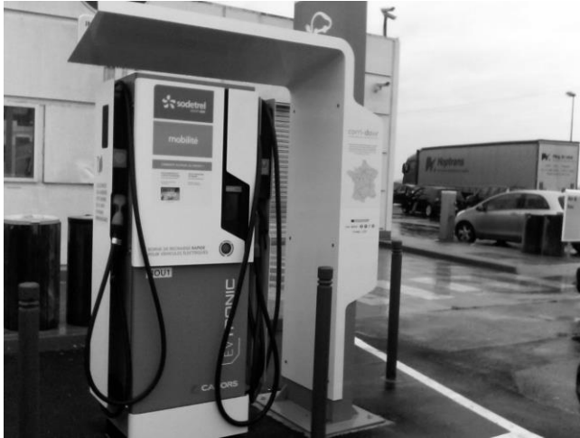
Photo 2 : Borne de charge rapide sur une aire d'autoroute
