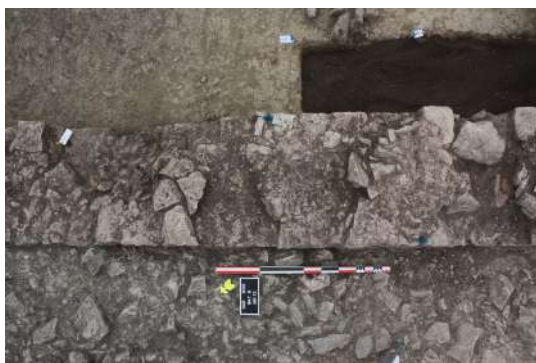
Fig. 109. Photo d'une partie abîmée du mur MR13 (Fait 6.4)
