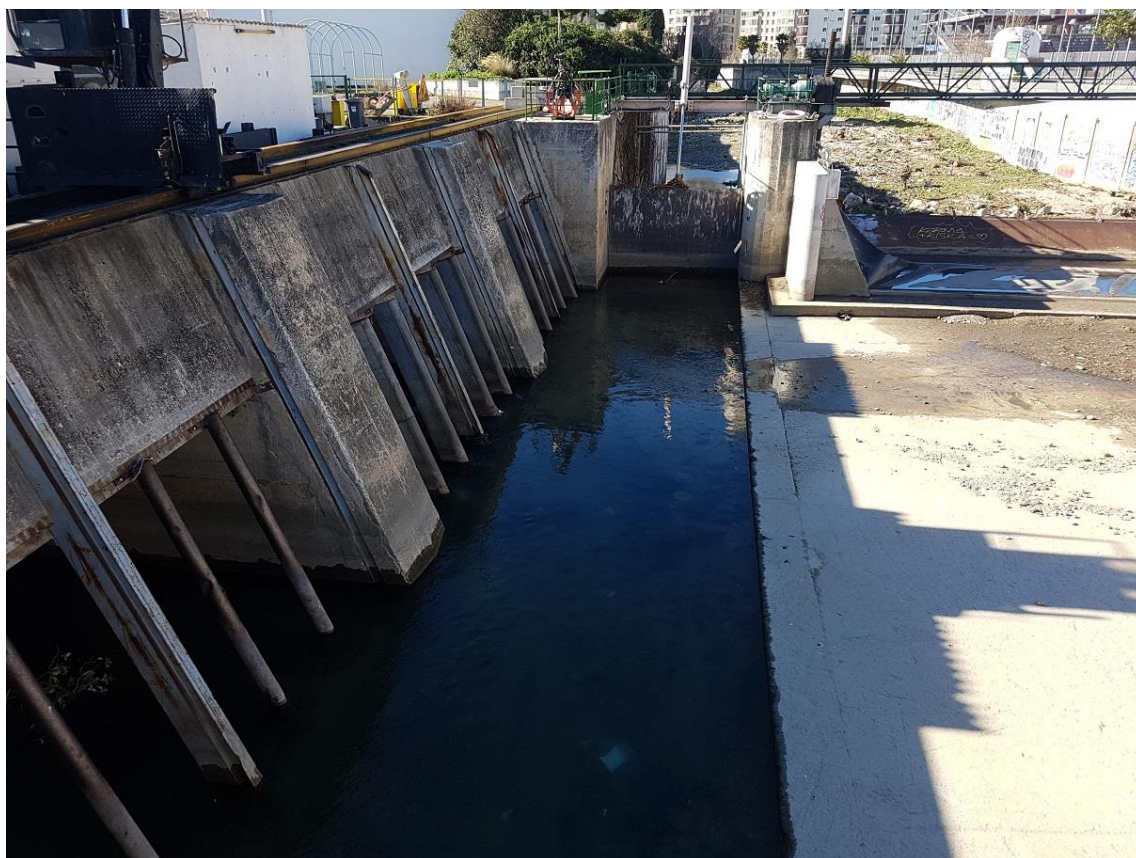
Photo 1 : Dégrilleurs de Pugette (Huveaune ; ©Eric Blin, Suez). Les dégrilleurs alignés avec 2 dégrilleurs d'entrefer 30 mm au fond (fonctionnement permanent), 2 dégrilleurs d'entrefer 70 mm au milieu (fonctionne à partir de 5 \text{ m}^3/\text{s} ) et une voie non dégrillée (à partir de 10 \text{ m}^3/\text{s} ), toutes voies conduisant vers les dessableurs, puis l'émissaire de Cortiou. En haut à droite, la vanne barrage amovible sur le lit naturel
