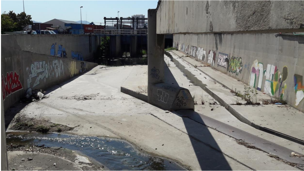
Photo 6 : Infrastructures de déstagement du ruisseau de Zoccola (Aygaldes ; ©Eric Blin, Suez). A gauche, vers des dégrilleurs d'entrefer 70 mm, à droite le bypass. Les eaux sont ensuite canalisées vers le GPMM.
