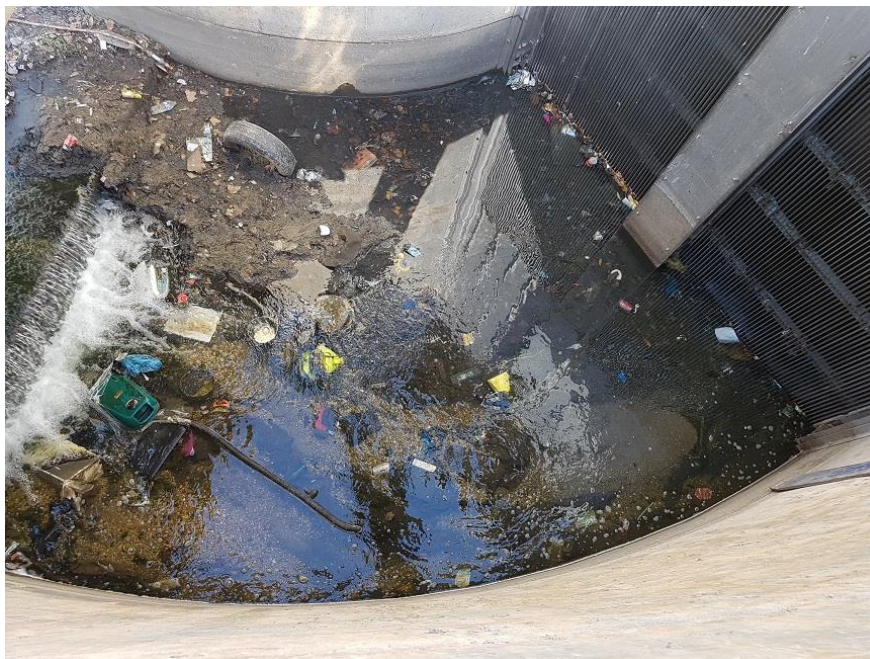
Photo 5 : Dégrilleurs d'entrefer 30 mm à Zoccola. (Aygaldes ; ©Eric Blin, Suez).
