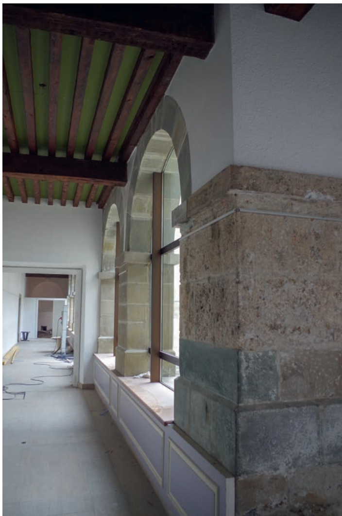
III. 06 : Pile en grès et tuf situé dans l'angle sud-ouest du cloître, les piles au second plan (galerie occidentale) sont en molasse ; photographie : Quentin Rochet
