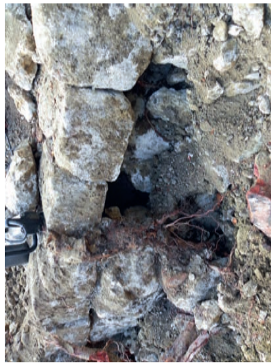
Vue des blocs de l'aquéduc nord déplacés par les racines
