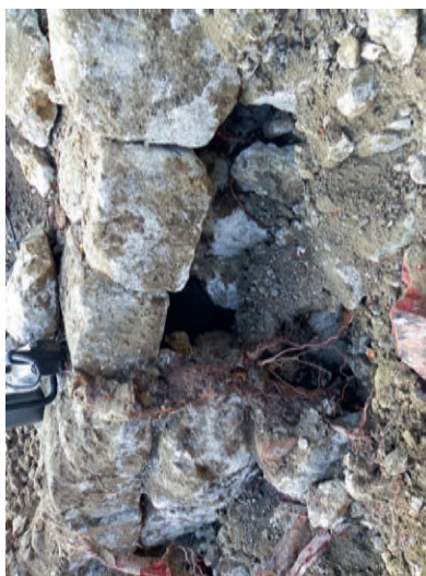
Vue des blocs de l'aqueduc nord déplacés par les racines
