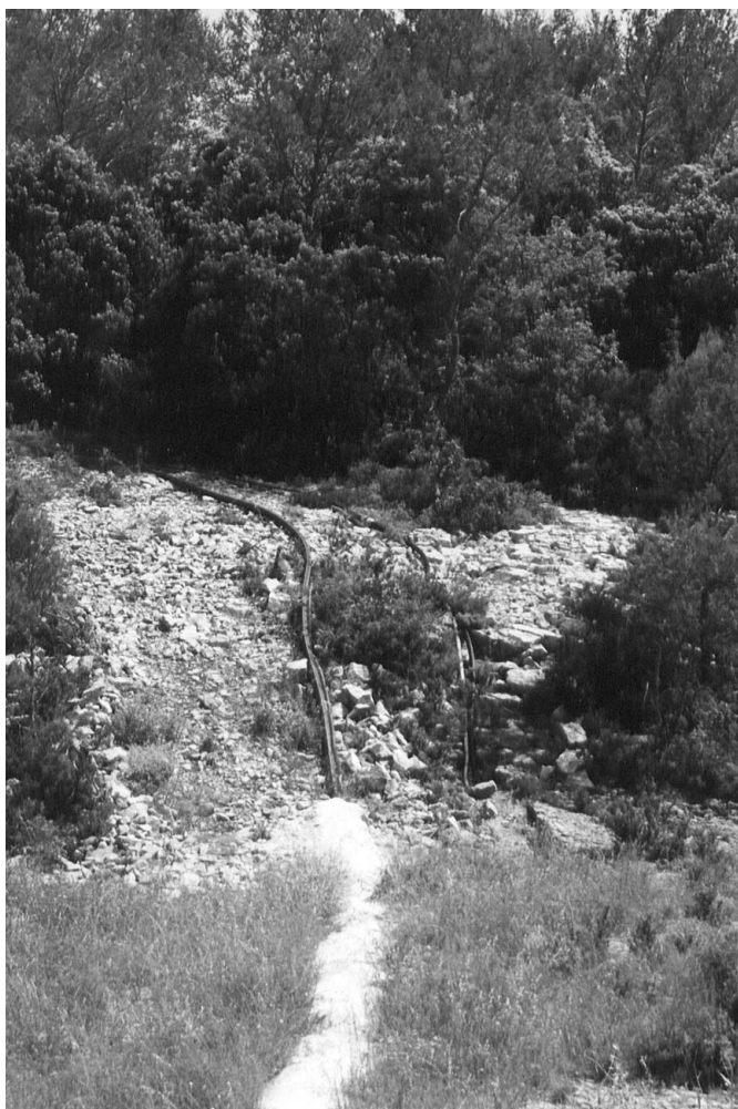
Photo 1 : Système de conduits amenant l'eau épurée de la station d'épuration au site d'irrigation Photo N.K.
