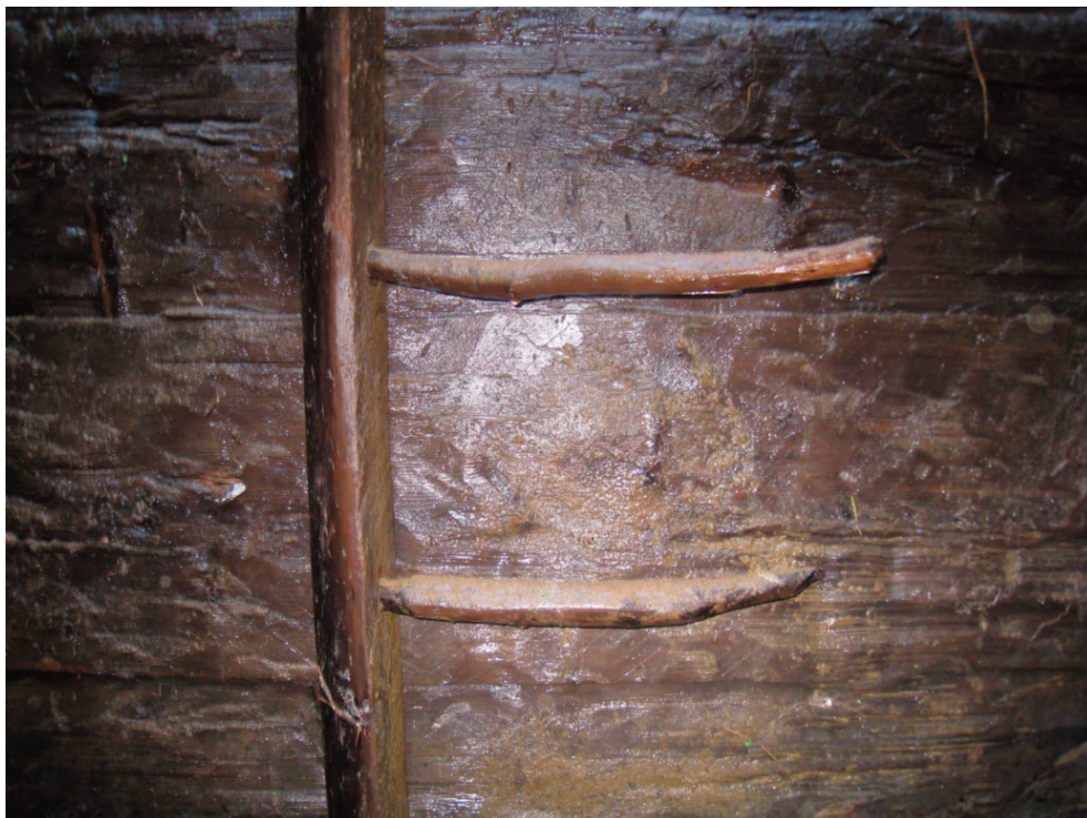
Fig. 44. Sainte-Croix – L'Auberson. Détail de l'échelle en bois encore en place dans le puits (photo M. Liboutet, AC).
