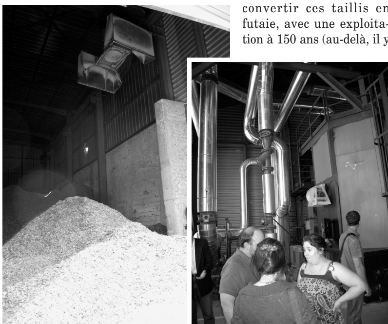
Photos 2 et 3 : Le hangar à plaquettes et l'intérieur de la chaufferie de Corte Photos DA
