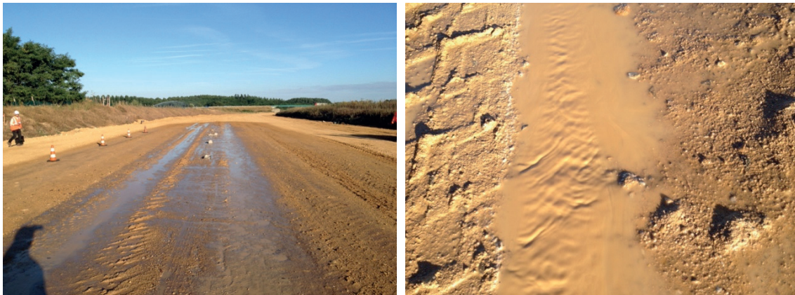
Figure 4 Flaques d'eau formées suite à un sur-arrosage de la piste
