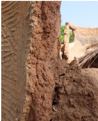
Mur effondré montrant la finesse de l'enduit décoré
