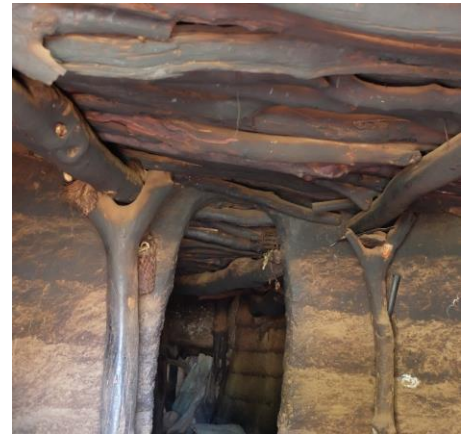
Vue de l'intérieur de 2 poteaux fourches supportant 2 poutres qui elles-mêmes supportent des poutrelles
