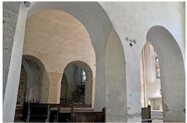
Fig. 24 - Gigny - grandes arcades du sanctuaire ouvertes sur les chapelles latérales (cl. R. Le Pennec)
