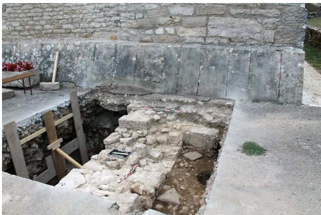
Fig. 27 - Gigny - sondage du parvis, mur gouttereau sud de l'avant-nef (cl. F. Henrion)
