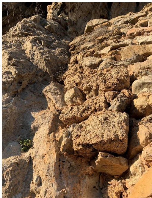
Fig. 3 Parement externe du mur barrant la grotte est – moellons en tuf et coup de sabre, dégradation en sous-œuvre – Image Denis Langlois
