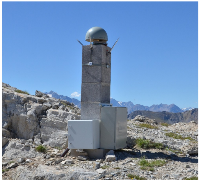
Figure 6: Installation géodésique ; le dôme contient l'antenne de réception du signal GNSS, les piques sont des paratonnerres, les deux coffrets électriques à la base du pilier béton contiennent les instruments de mesure ainsi que les batteries de secours. Le pilier se situe sur la crête entre l'entrée du fort sous-terrain et l'ancien fort.
