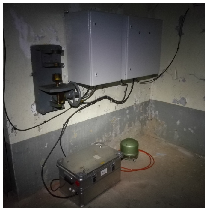
Figure 7: Installation sismologique ; avec coffrets d'alimentation électrique et système de domotique. La caisse en alliage d'aluminium contient les batteries de secours, et le capteur sismique est visible en bas à droite. L'ensemble est installé dans le bloc 2 «salle des canons mortiers ».
