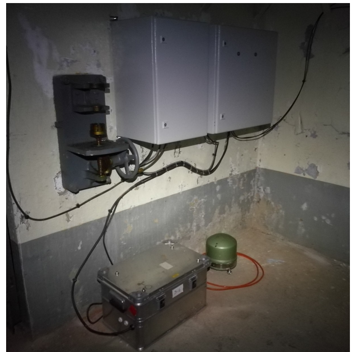
Figure 7: Installation sismologique ; avec coffrets d'alimentation électrique et système de domotique. La caisse en alliage d'aluminium contient les batteries de secours, et le capteur sismique est visible en bas à droite. L'ensemble est installé dans le bloc 2 «salle des canons mortiers ».
