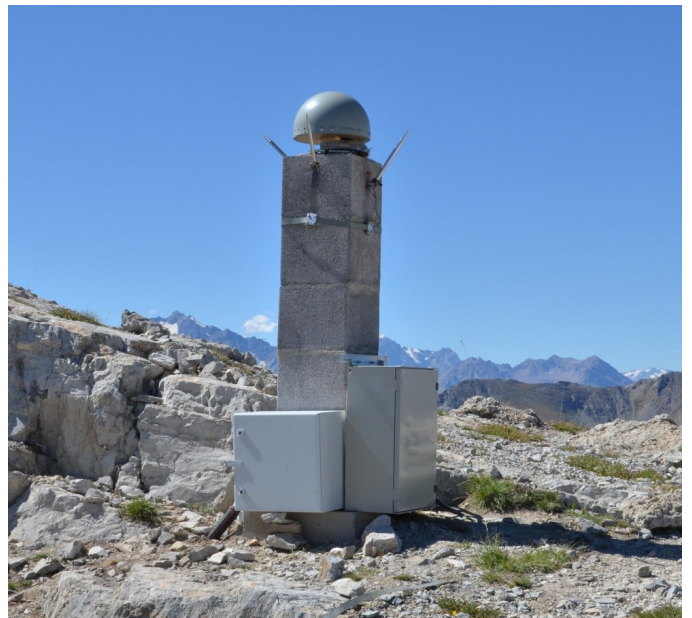
Figure 6: Installation géodésique ; le dôme contient l'antenne de réception du signal GNSS, les piques sont des paratonnerres, les deux coffrets électriques à la base du pilier béton contiennent les instruments de mesure ainsi que les batteries de secours. Le pilier se situe sur la crête entre l'entrée du fort sous-terrain et l'ancien fort.
