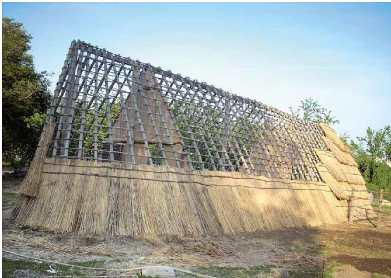
Fig. 22 Parc de S. Paolo Belsito. Reconstruction de la Maison 4 de Nola: structure de la charpente (lites horizontaux et chevrons verticaux avec pose des faisceaux de gerbes).
