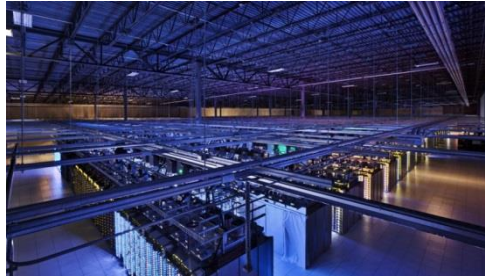
Google Data Center (Iowa)
