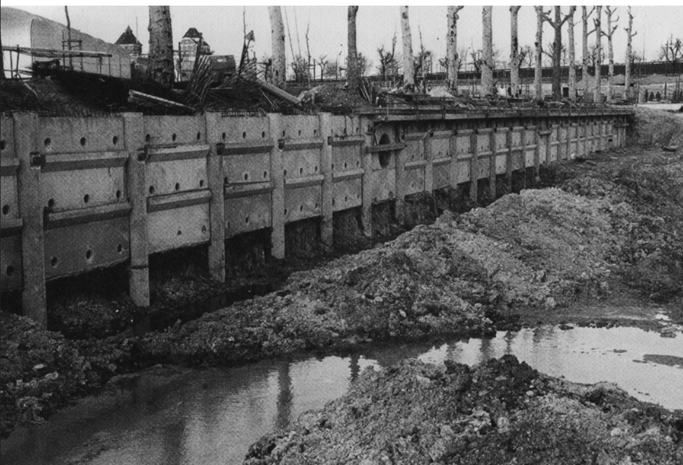
Le «mur à la parisienne» en cours de coffrage (in ibid. , p.26).
