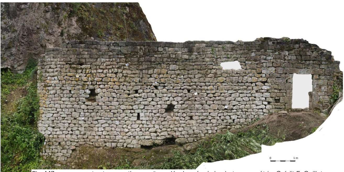
Fig. M7 en parement externe, orthomosaïque développée de la photogrammétrie. Crédit F. Guillot
