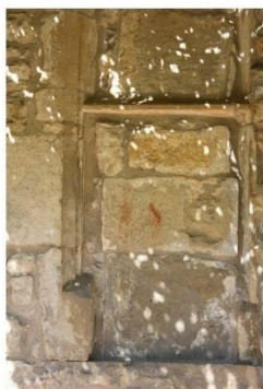
Fig. 43 - Détail de l'encadrement de la croisée maintenant obturée.
