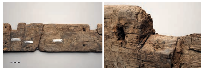
Fig. 74 – Toulon 2: a) la serre bauquière tribord avec deux entailles pour des barrots; b) détail d'une encoche sur le bord supérieur (clichés L. Damelet).
