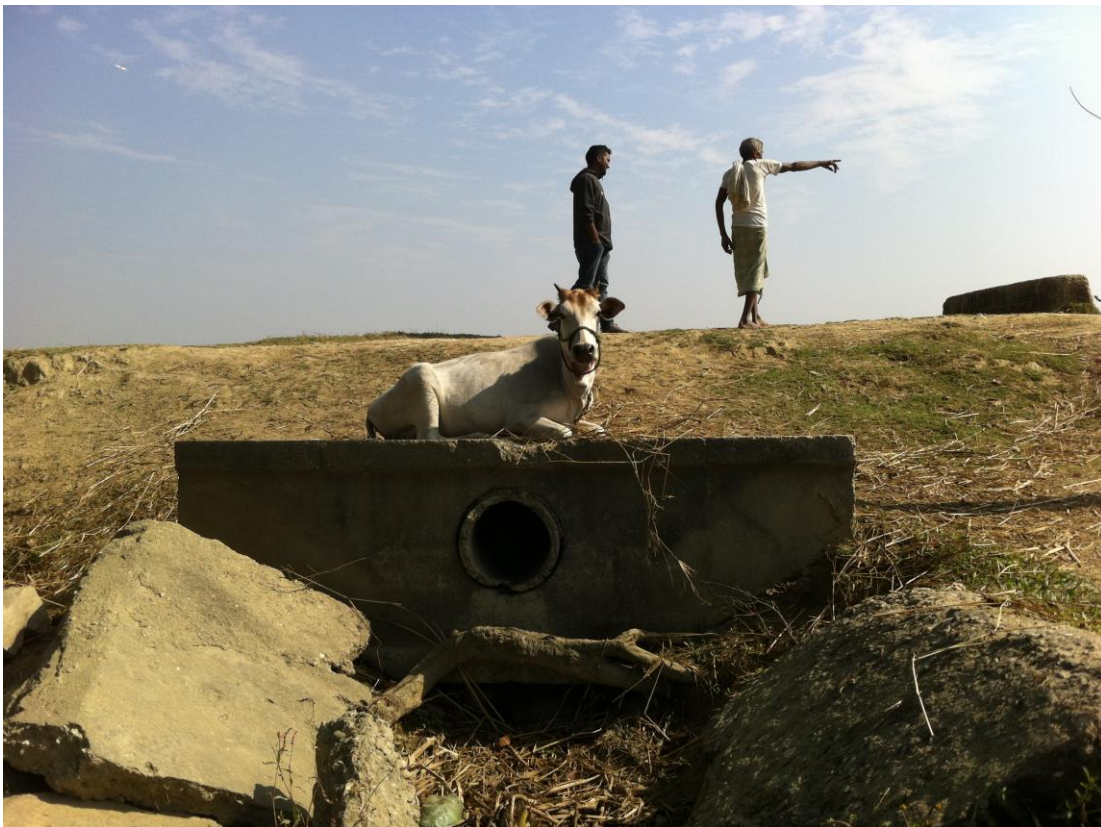
Des infrastructures endommagées : la prise d'eau d'un chenal depuis un canal tertiaire, en compagnie du président de ce chenal (Cliché : R.Valadaud 2017)
