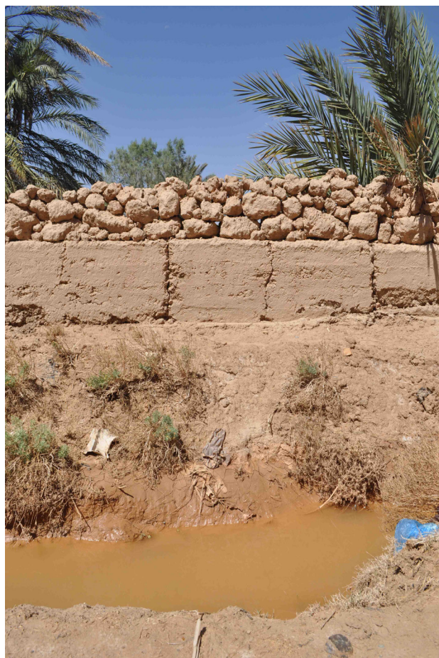
Fig. 15 – Exemple actuel d'un mur de clôture bâti en terre en lien avec un fossé dans la région de Rissani au Maroc (clichés : C.-A. de Chazelles)
