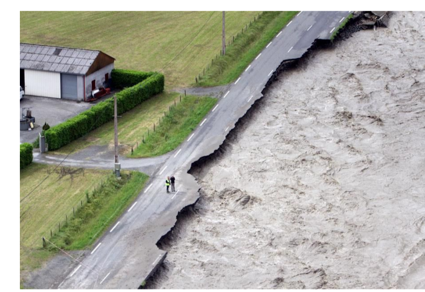
Crue torrentielle du Bastan (Luz-St-Sauveur)
