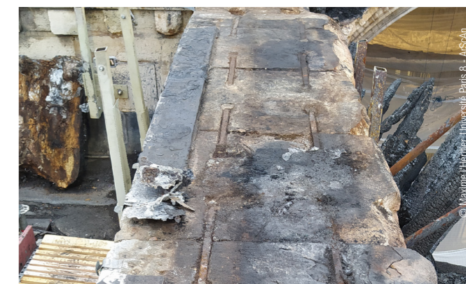
Plombs de scellement d'agrafes en fer dans le mur bahut du chœur.
