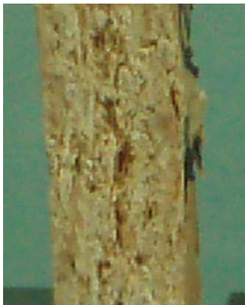
Figure 4: Mécanismes de dégradation (délaminage longitudinal)
