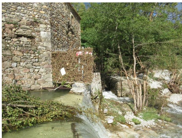
FIG.5 — BARRAGE DU SITE DE ROUCAN – GARDON DE MIALET ; PRISE D'EAU DU BÉAL DE LA BAMBOUSERAIE ; LA GRILLE DE PROTECTION DU CAPTAGE EST ENTIÈREMENT RECOUVERTE DE DÉBRIS VÉGÉTAUX ; LES ARBRES DE RIVE GAUCHE ONT ÉTÉ ÉTÊTÉS ET POUR PARTIE BROYÉS.
