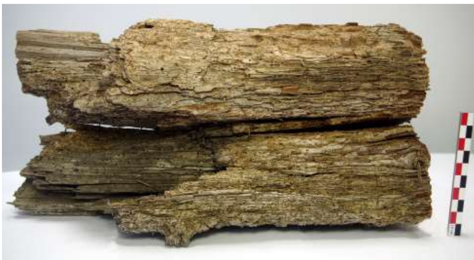
Fig. 11 : Partie découpée du tirant T1-2
