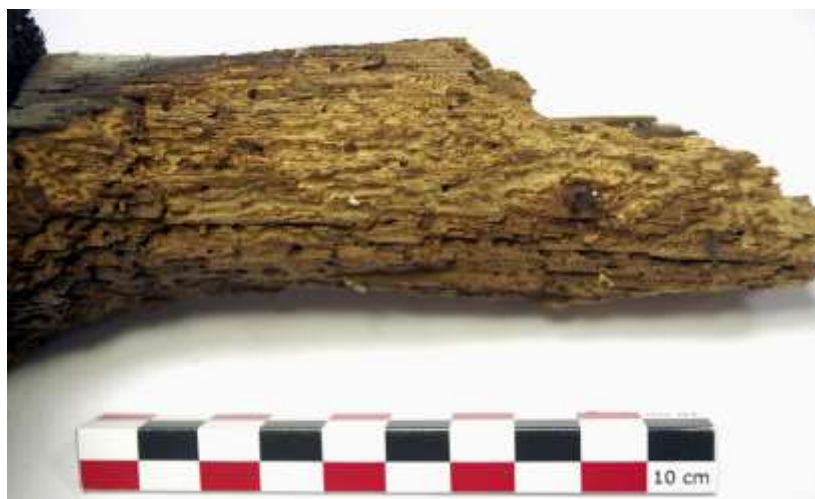
Fig. 20 : Bois très dégradé du tirant T7-8
