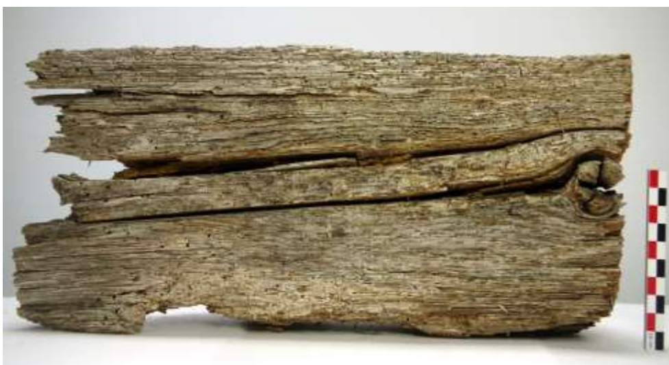
Fig. 13 : Partie découpée du tirant T1-2
