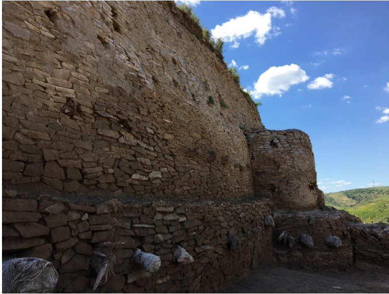
Mur de la plateforme palatiale de Shimao avec poutres en bois. © Liu Xiaoxi
