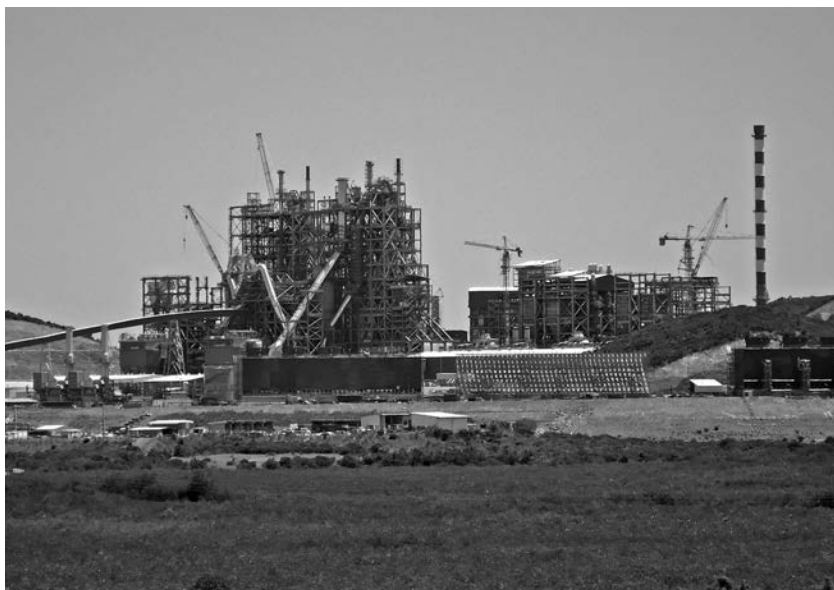
L'usine en construction en 2012, vue du bar de la base-vie. © C. Salomon
