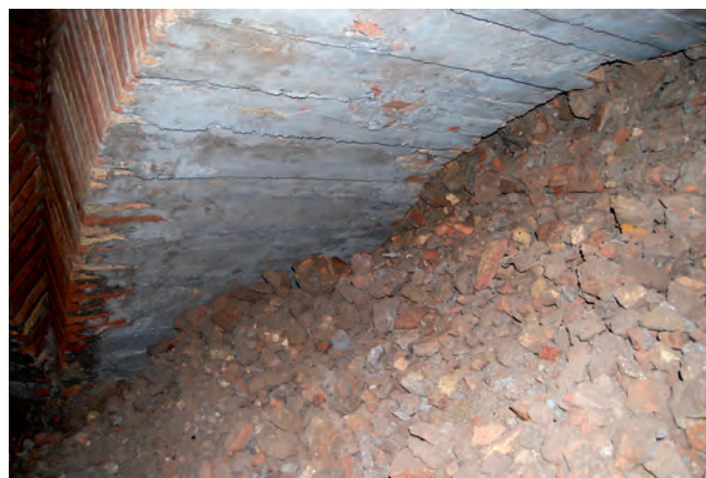
5 – ROMA, PALATINO, AREA DELLA VIGNA BARBERINI RESTI DELL'IMPRONTA DELLA CENTINA SULL'INTRADOSSO DI UN ARCO DEL PRIMO ORDINE, IN FASE DI SCAVO
