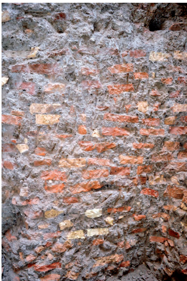
18 – ROMA, PALATINO, AREA DELLA VIGNA BARBERINI PORZIONE DELLA MURATURA DI ETÀ NERONIANA TAGLIATA PER LIBERARE E RECUPERARE GLI ELEMENTI CHE ERANO STATI FISSATI AL SUO INTERNO
