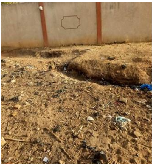
Photo 3. Clôture de maison menacée par l'érosion pluviale
