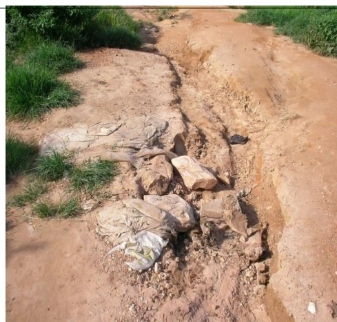
Photo 2 : Ravinement d'une rue vers Fourignikèrè
